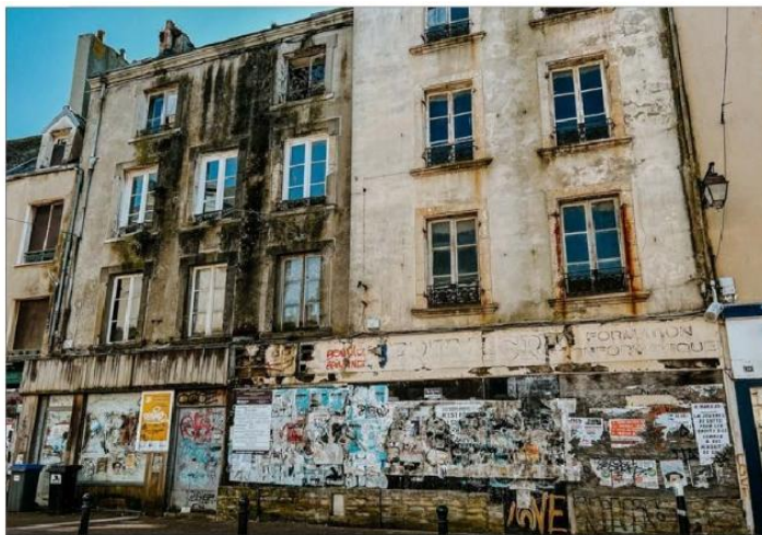
La place de la Révolution, où des immeubles insalubres seront prochainement démolis dans le cadre de la lutte contre l'habitat indigne.
